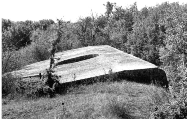
Северное укрепление. Блок броневеого наблюдательного поста так и неустановленным колпаком совмещен с выполненным в виде коленчатого сквозника выходом из потерны, соединяющей горжевую казарму с первой линией обороны.
