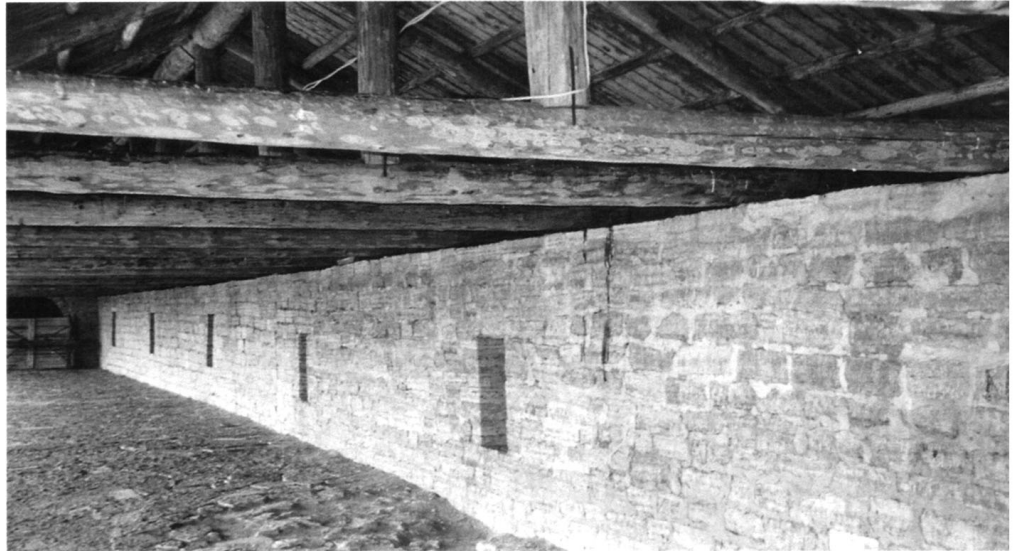
Боевой ход стены между Климентовской и Воротной башнями. Парапет с прямоугольными боевыми окнами.
